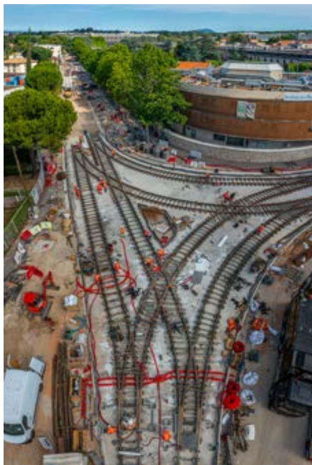
▼ Connexion de la ligne 5 sur la ligne 1 à St Eloi pour le tram de Montpellier
