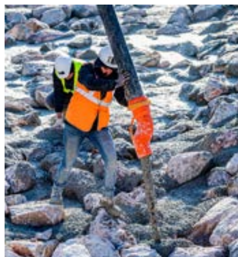
▼ Bassin de rétention de Frontignan
