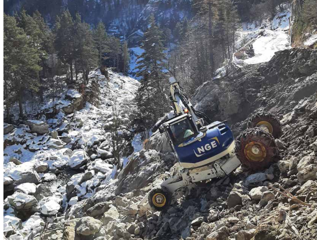
NGE junto a la cama del Valle de Roya. Aquí, la araña excavadora realiza los primeros estudios
