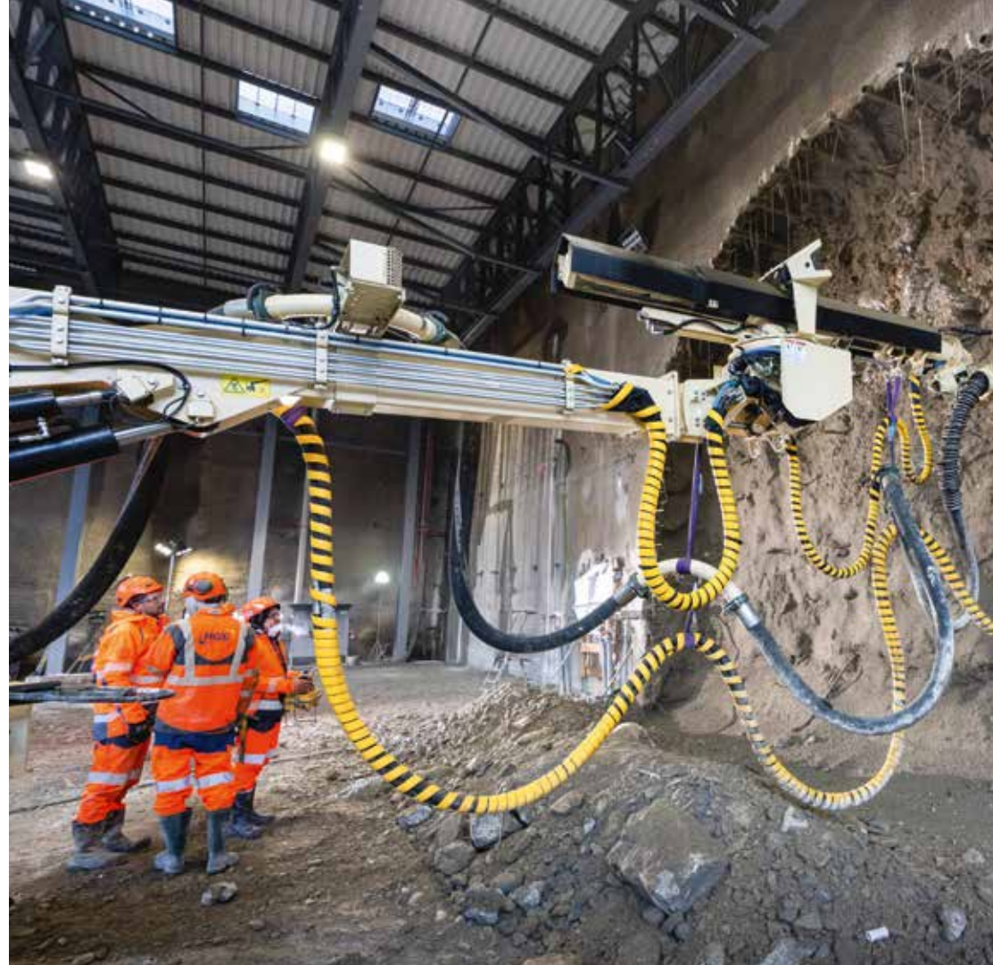
▼ Inicio de la excavación de la boca del túnel Lyon-Turín desde el lado francés
