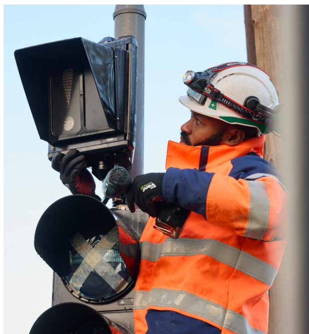
Instalación de señalización tricolor en Bordeaux (33)
