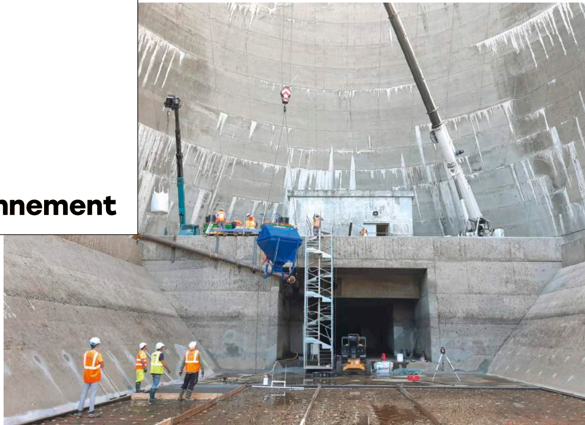
Rénovation du bassin de Soulages à Saint-Chamond avec un béton fibré à ultra-hautes performances
